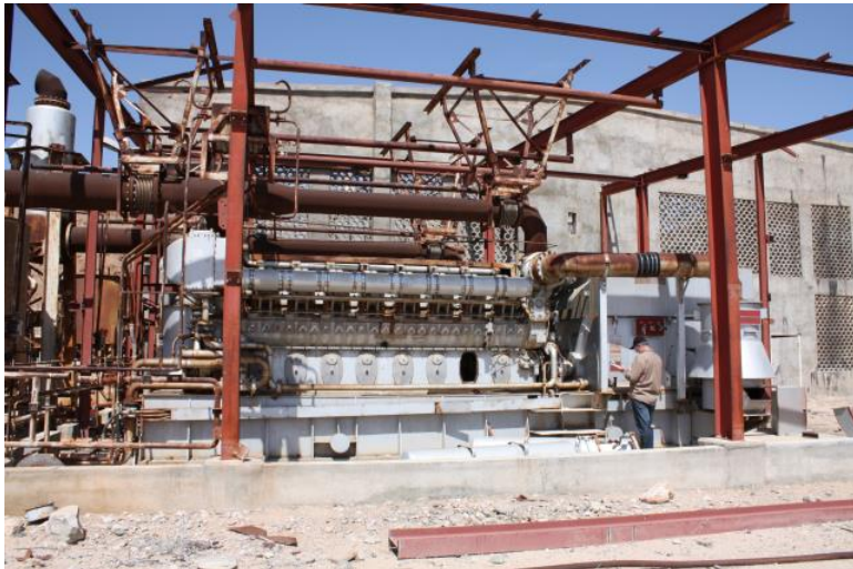
43a) Energy Center
